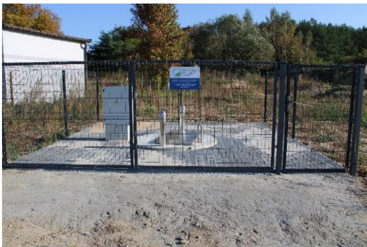
Sietciowa przepompownia ścieków w miejscowości Nowodwór
